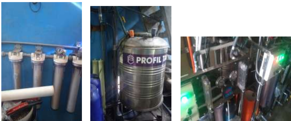
Gambar 2. Sistem Filtrasi di Lokasi Mitra Sumber: Dokumentasi tim, 2025
